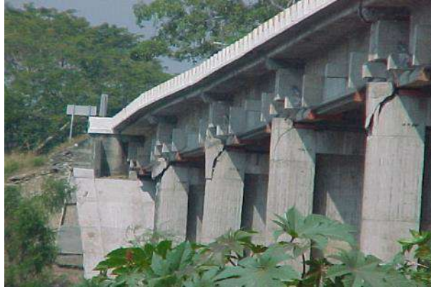
Figura 1. Daños en toques sísmicos del puente Coahuayana ante el sismo de 1995.
