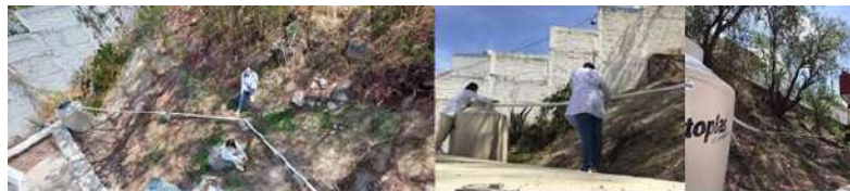
Figura 4.b. Sistema de conducción de agua de lluvia del captador de primeras lluvias al tanque de almacenamiento.
