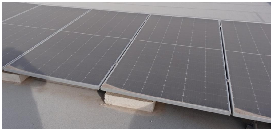
Imagen 11. Cinco paneles solares en salón. Se aprecian cubiertos de polvo.
