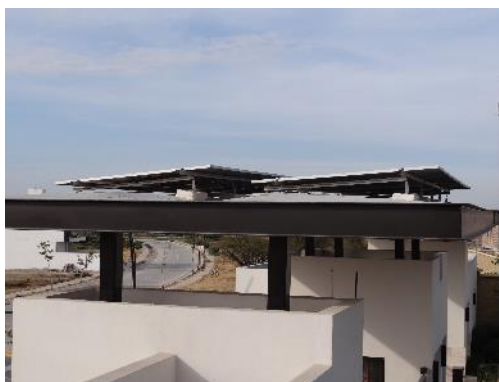
Imagen 14. Paneles solares en caseta de vigilancia.
