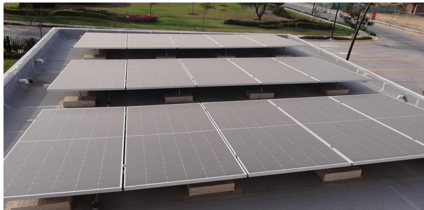
Imagen 12. Grupo de otros quince paneles solares en salón. Se aprecian cubiertos de polvo.
