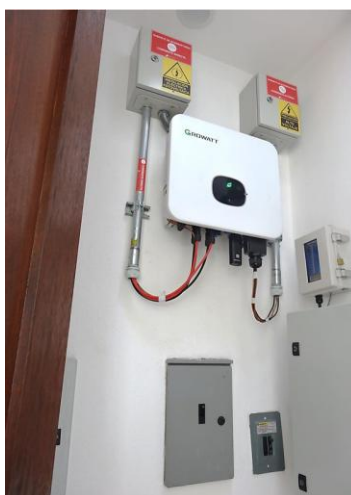
Imagen 7. Instalación del inversor del salón.
